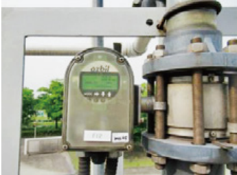
⑥放流槽の電磁流量計の 停止を確認
