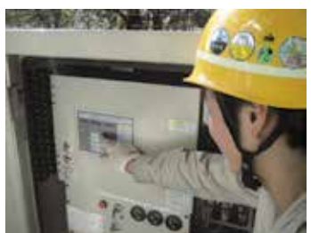
⑤自家発電装置の稼働を確認 (No.2,3STC 炉)
