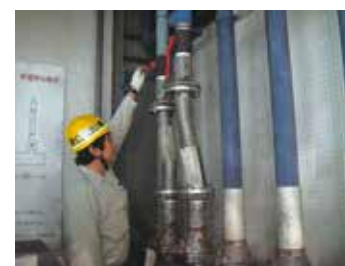
⑤冷却水バルブの切換え (No.2 連続炉)
