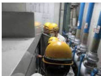
⑤自家発電装置の移動確認 (No.2,3STC 炉)
