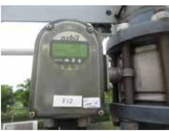
⑥放流槽の電磁流量計の停止を確認
