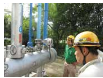
⑤冷却水バルブの切換え確認 (No.2 連続炉)
