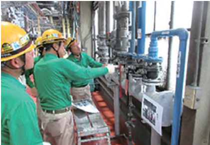
⑤ 冷却水バルブの切換え確認
