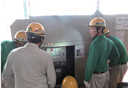
⑤ 自家発電装置の動作確認
