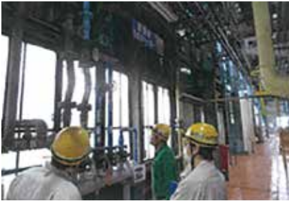
⑤ 冷却水バルブの切換え確認
