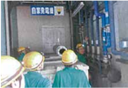
⑥ 自家発電装置の動作確認
