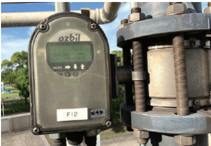
⑥ 流量計により流出停止を確認
