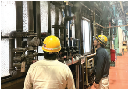
⑤ 冷却水バルブの切換え確認
