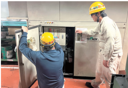
⑤ 自家発電装置の動作確認
